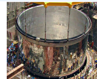
PFBR, 500 MW(e) India, 2024
