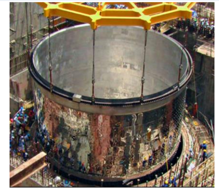
PFBR, 500 MW(e) India, 2024
